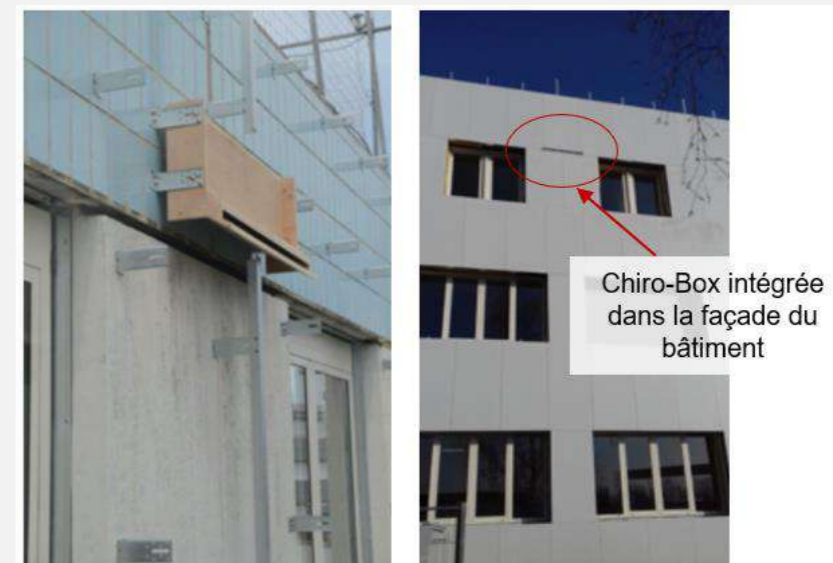
Figure 210 : Gîtes d'hivernation à chauves-souris intégrés aux façades des bâtiments
